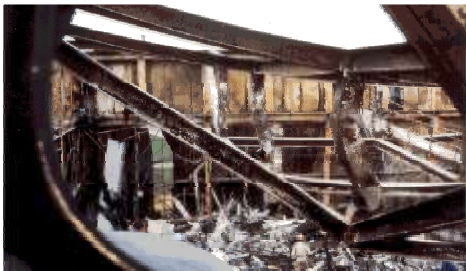
LA ESTRUCTURA MALTRATADA
